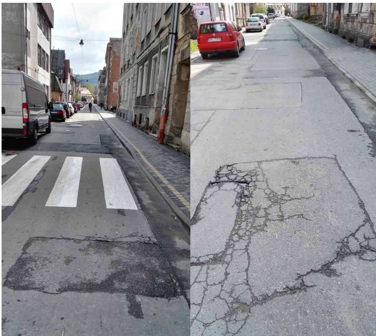
Fotografie: ul. Zdrojowa wymagająca pilnego remontu
