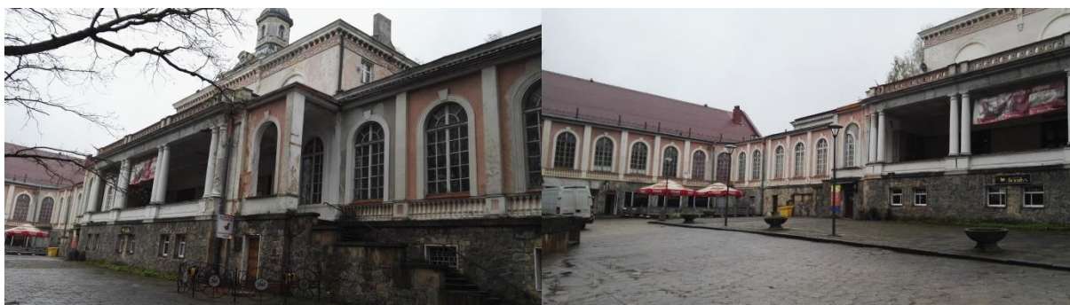
Fotografia: dom zdrojowy przy ul. Orlej, wymaga remontu i ewentualnej adaptacji pod inne funkcje
