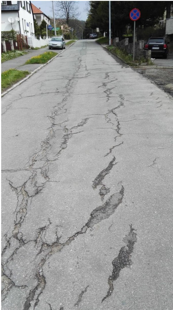
Fotografia: spękana nawierzchnia ulicy Wolności
